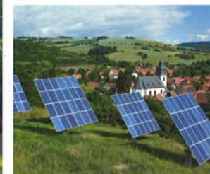
Dank einer Photovoltaikanlage ist der Sonnenpark praktisch energieautark. Aus einem „Bio-Solar-Haus“ wird mit einer solchen Anlage schnell ein Energie-Plus-Haus.
