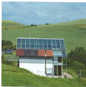
Die „gläserne Haube“ läßt die Sonne ein und sorgt so für Energiegewinne.
