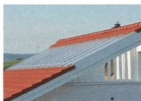
Hausdach mit Plexiglas für solarthermische Anlage
